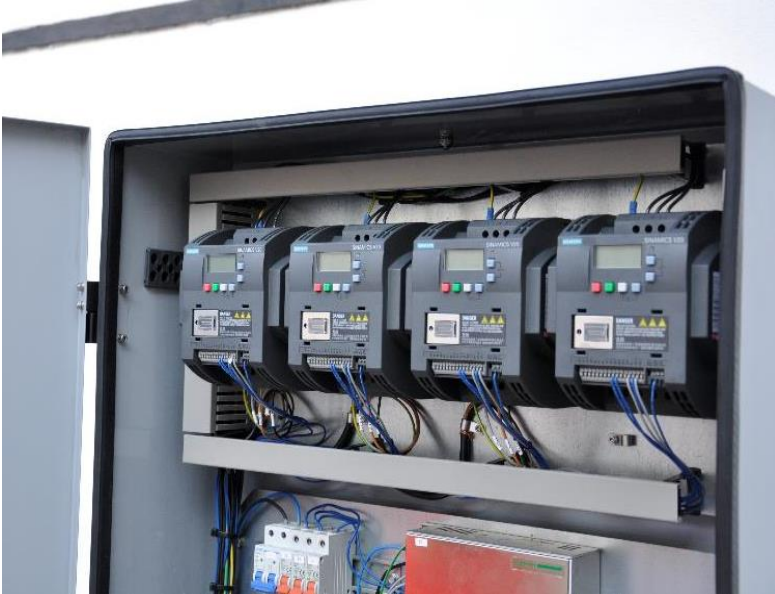
Variadores Frecuencia y Control de la programación PID
